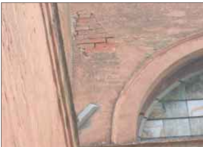
Fig. 5.b: Fessura presente sulla finestra della cappella di destra (riferimento 5)
