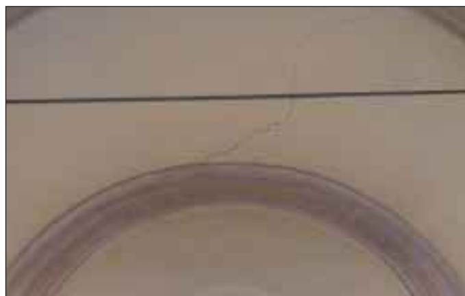
Fig. 3.b: Vista della lesione in corrispondenza dell'arco di facciata (riferimento 2)
