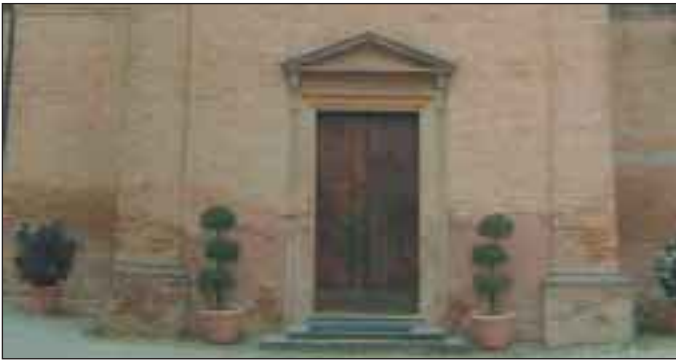
Fig. 22: Intervento 9: manutenzione della malta danneggiata da bagnatura e gelo – disgelo mediante ristilatura con malta di calce pozzolanica esente da alcali
