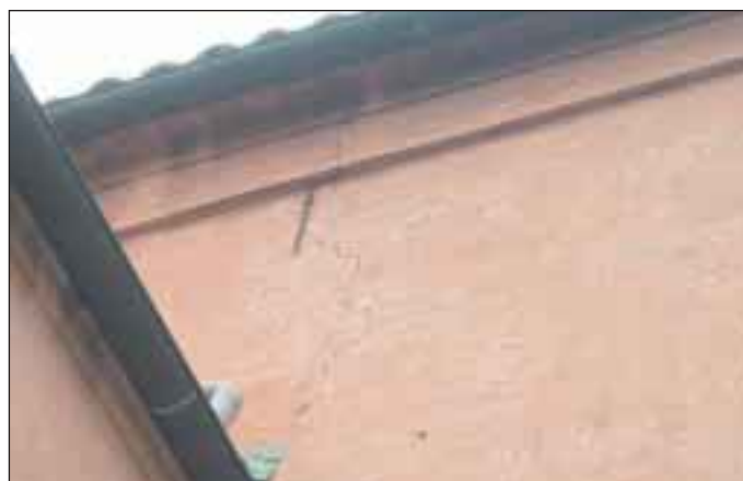
Fig. 5.c: Fessura presente tra navata e transetto (riferimento 6)
